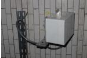
Capteur d'arrêt du train CA (Radar)
